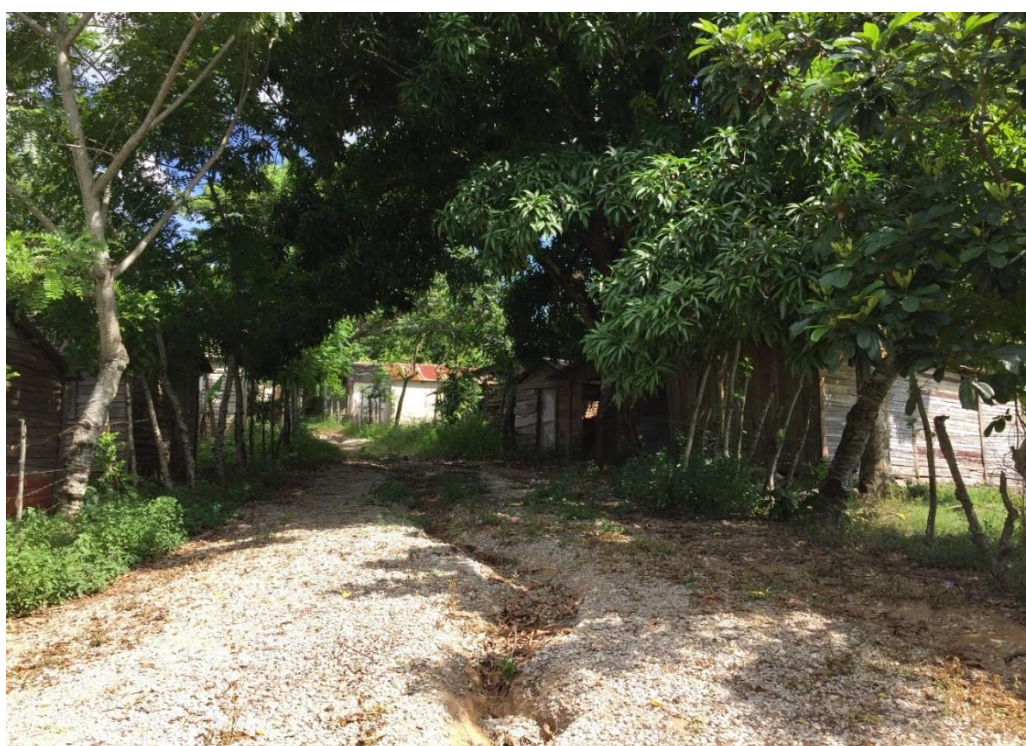
Figura 26: Caminos deteriorados en la comunidad Las Lagunas
